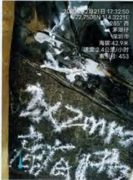
图 8.1 渗漏破损处图片
