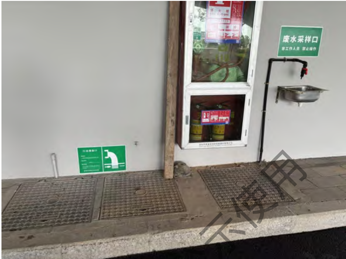
图 4.3-1 废水排放口照片
