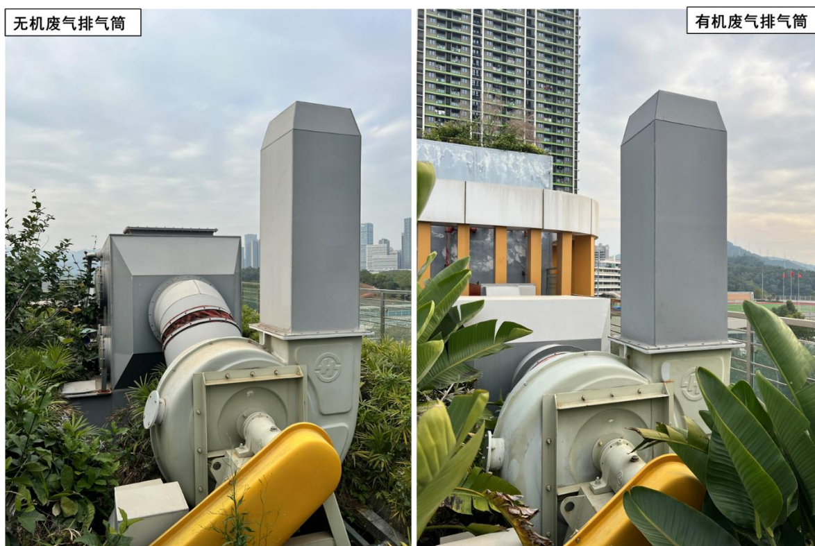
图 5-3 化验室排气筒
