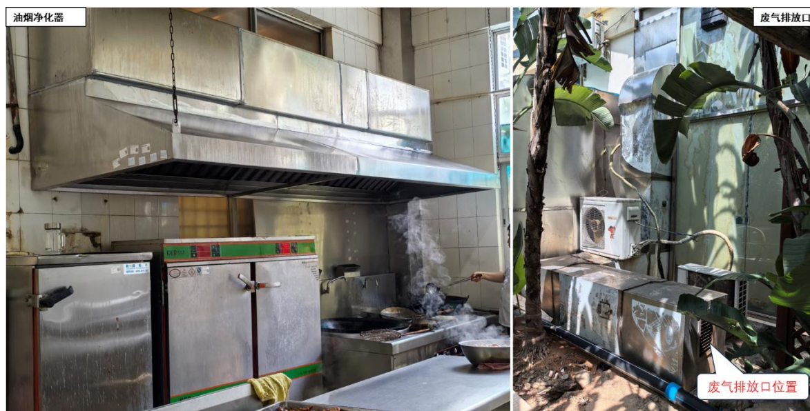
图 5- 2 食堂油烟净化器及排放口
