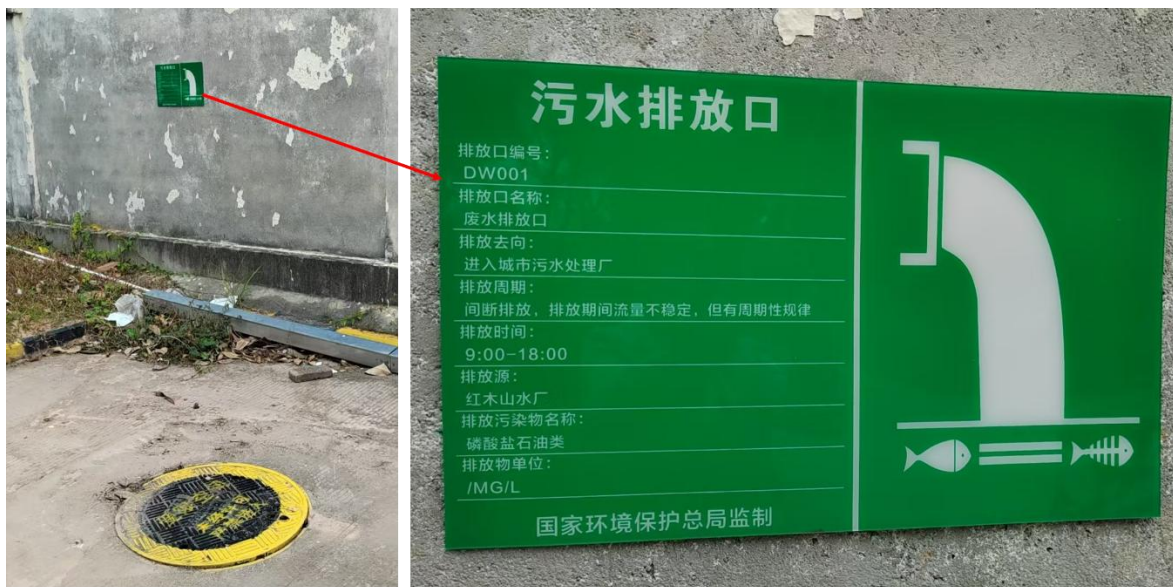
图 5-6 生产废水排放口照片
